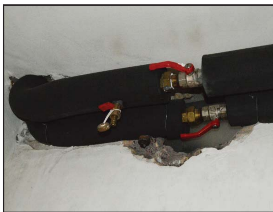
Problematické dodatečné zateplení rozvodů-prostor, armatury Zdroj: fotodokumentace autora
